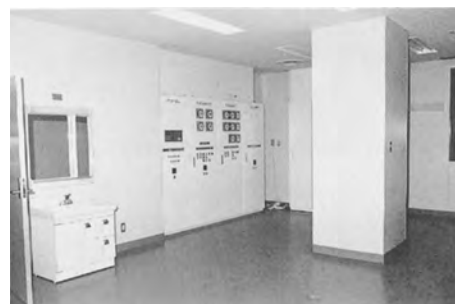
〈コントロール室〉
